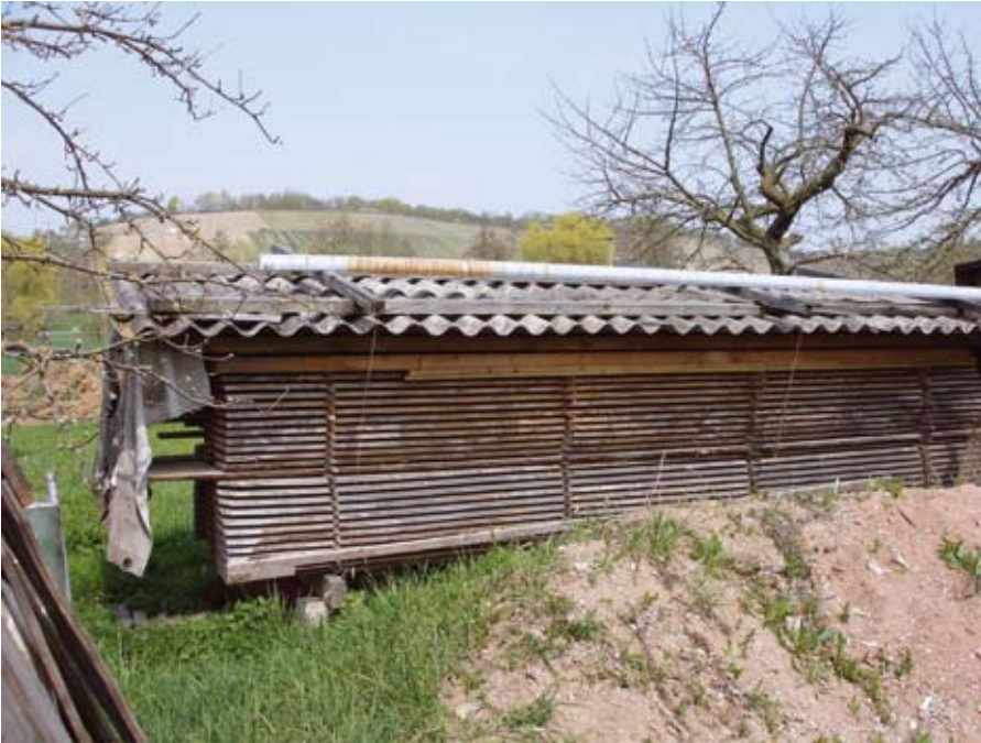
Verbotene Wiederverwendung von asbesthaltigen Dachplatten zum Abdecken von Holzstapeln
